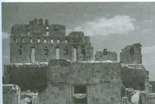
Figura 9. Vista de la crestería con los pilastres numerados, desde el costado sur del edificio (foto: Proyecto Arq. DZK).
